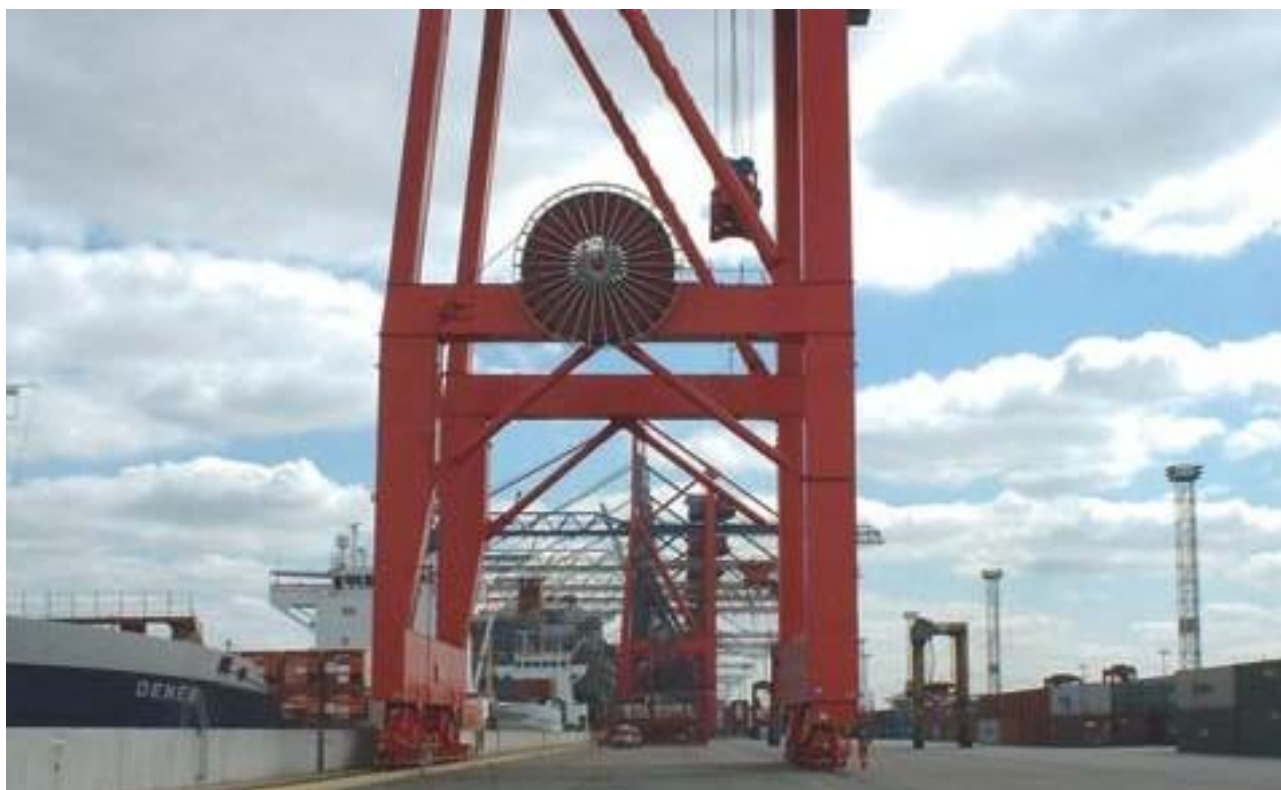
Кабельный барабан с электроприводом LT 25/72 H4K 240/LWL-18/FPGL на контейнерном кране в порту Гамбурга, используемый для намотки кабеля 10 кВ. Приведение в действие посредством короткозамкнутого двигателя с преобразователем частоты.
