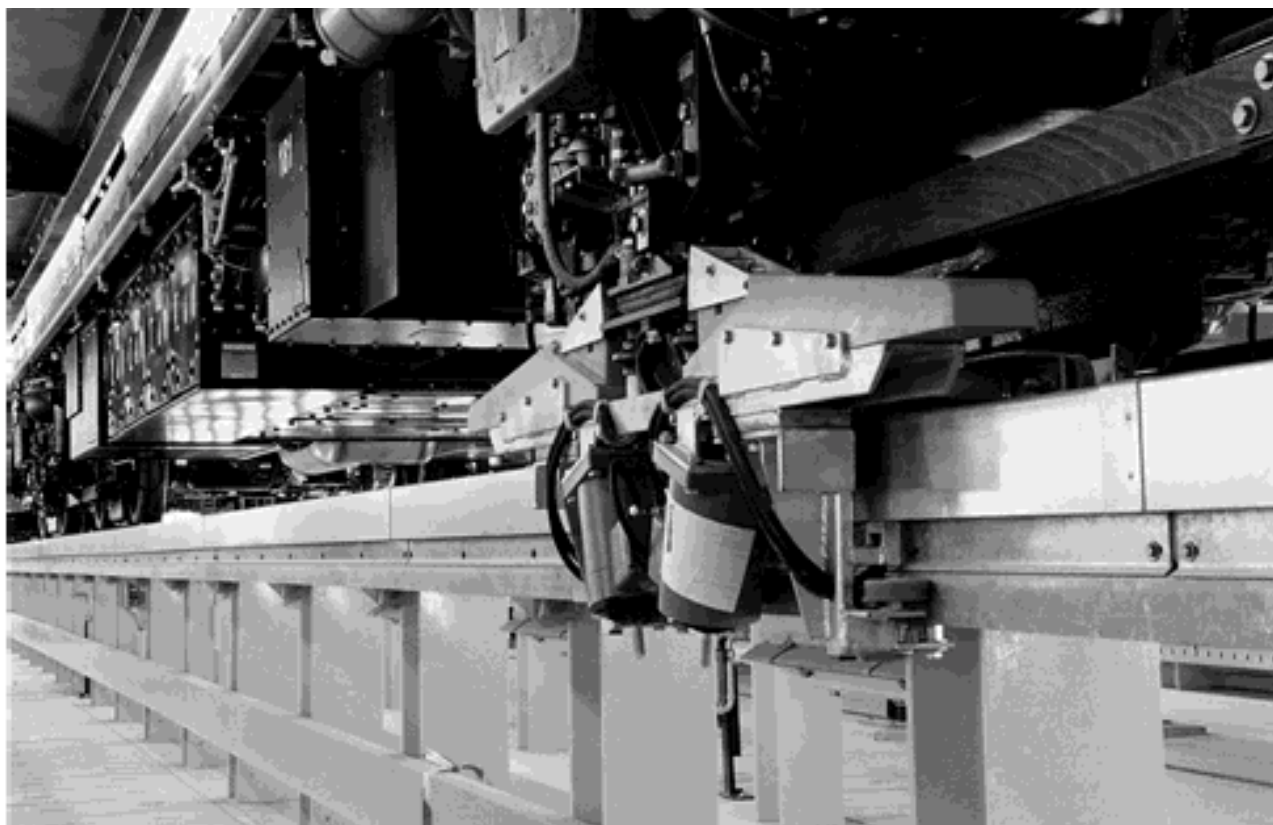
Закрытый шинопровод для отрезков технического обслуживания линий метрополитена.
