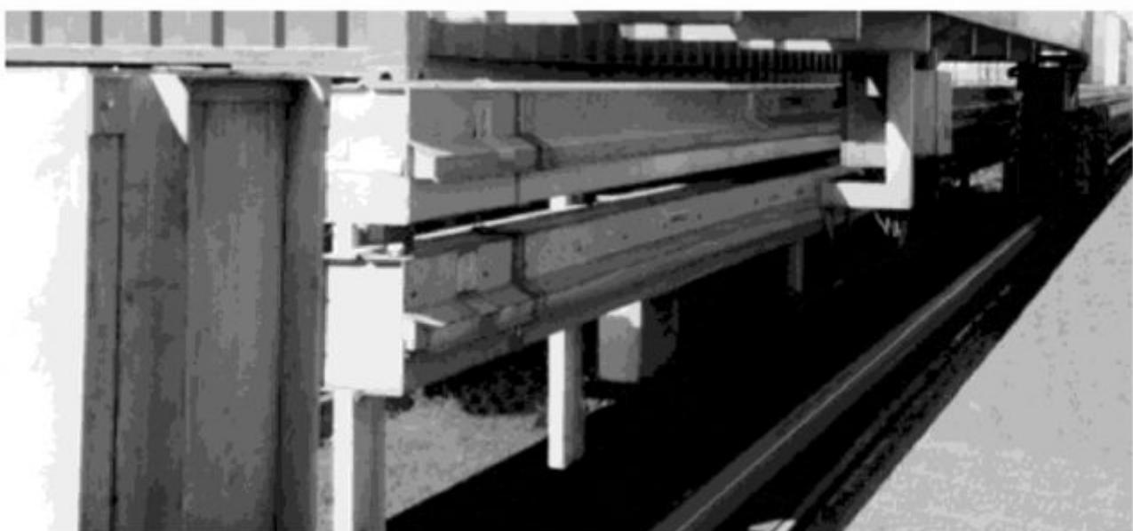
Шинопровод FK на контейнерном терм.
